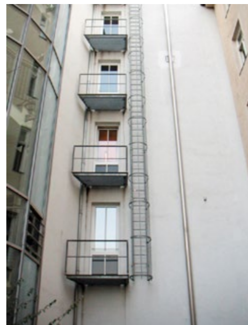
Fehlerhafte Notleiteranlage ohne gesichertes Leiterende; diese stellt eine Gefahr für Gebäudenutzer und Einsatzkräfte dar.
