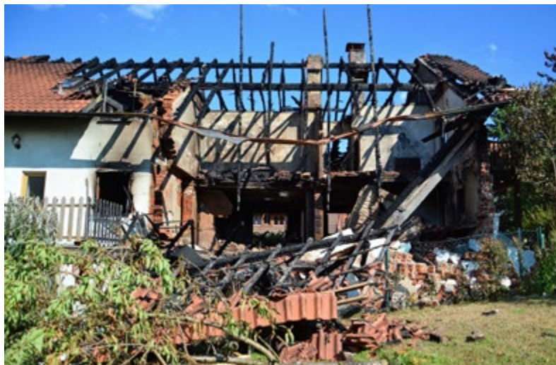
Die gleiche Ansicht nach den Löscharbeiten. Kurz darauf entschloss man sich, unter entsprechenden Sicherheitsvorkehrungen das Gebäude abzutragen..
